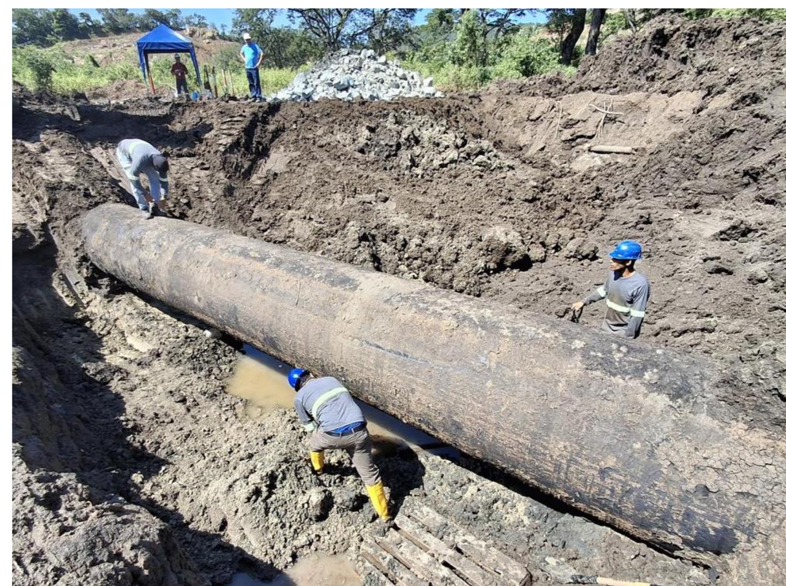
Figura 1. Tubería expuesta en zona húmeda: implicaciones del nivel freático alto en Guayaquil.
