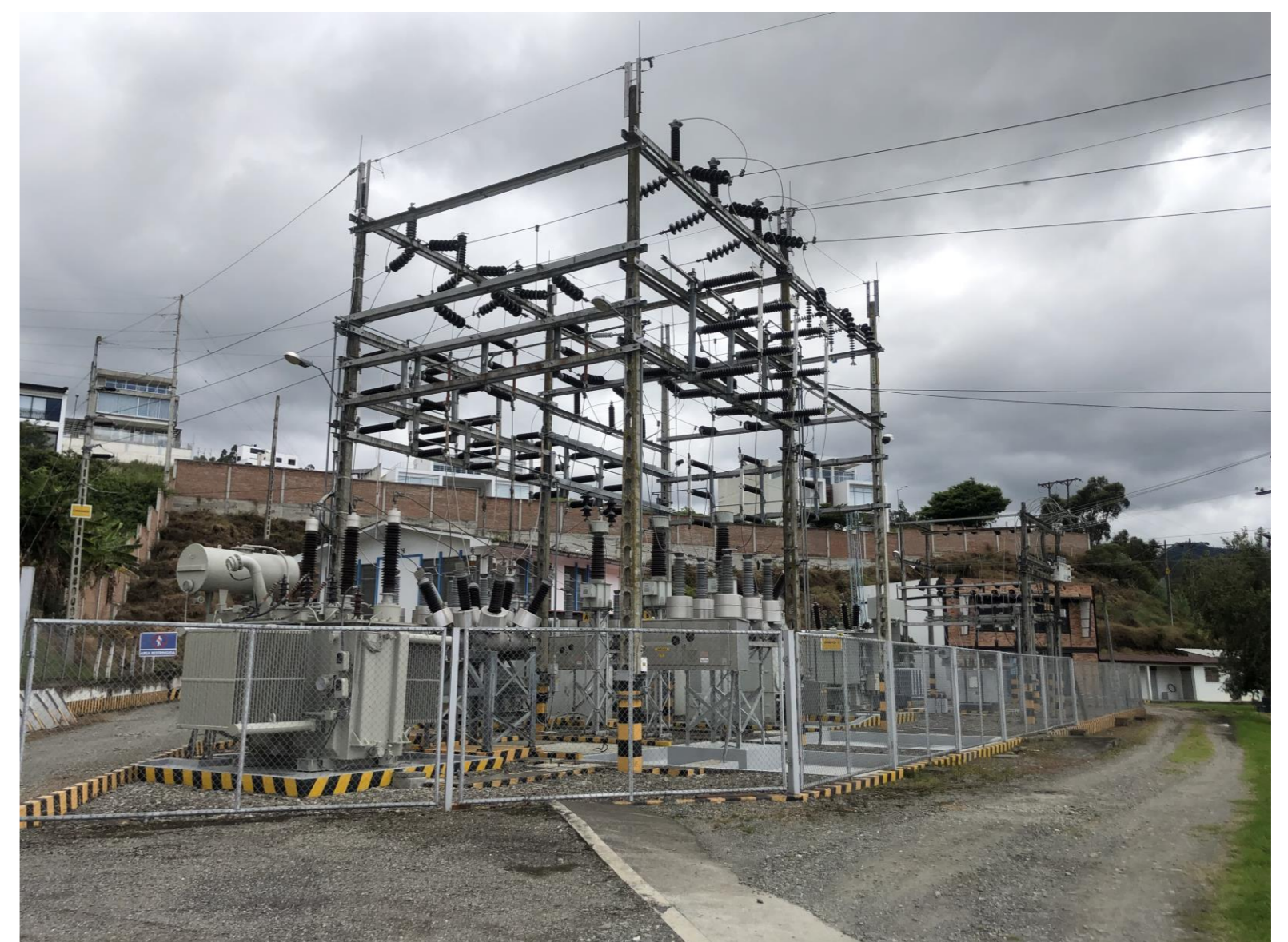
A-) Subestación San Cayetano de la EERSSA.
