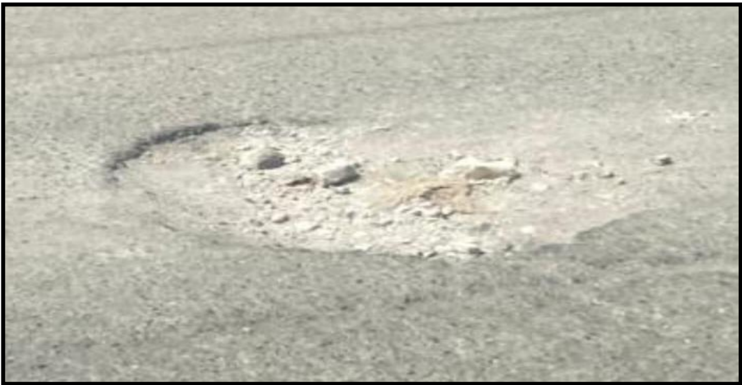
Presencia de baches
