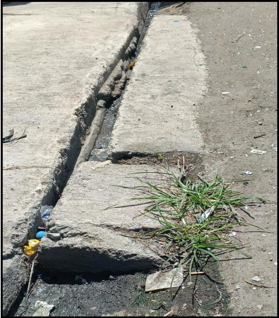
Deficiencia en el drenaje
