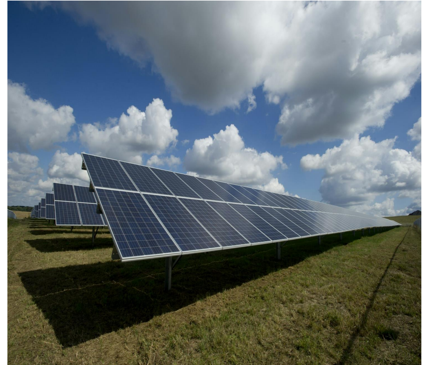
Figura 1. Disposición de paneles fotovoltaicos para captación de energía solar.
