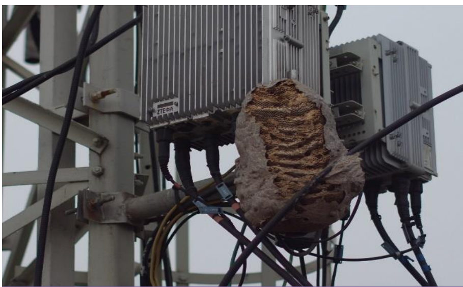
Ilustración 5. Panel de abejas encontrado durante la inspección
