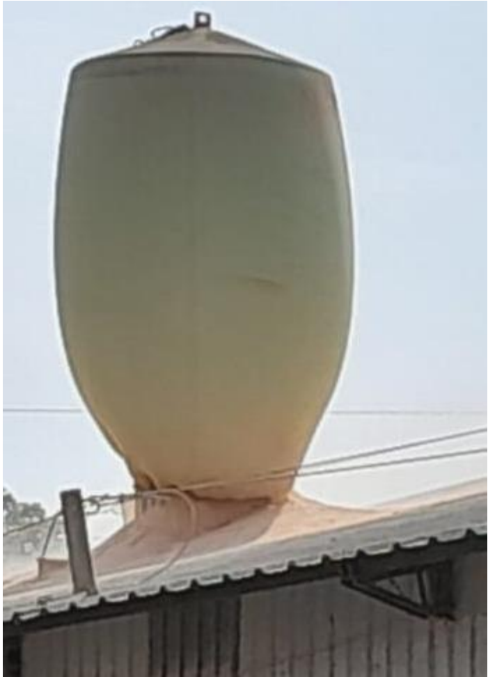
Ilustración 2: Acumulación de producto en la cubierta.
