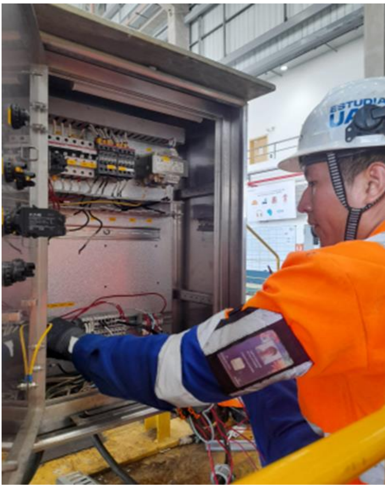
Optimización del tablero eléctrico
