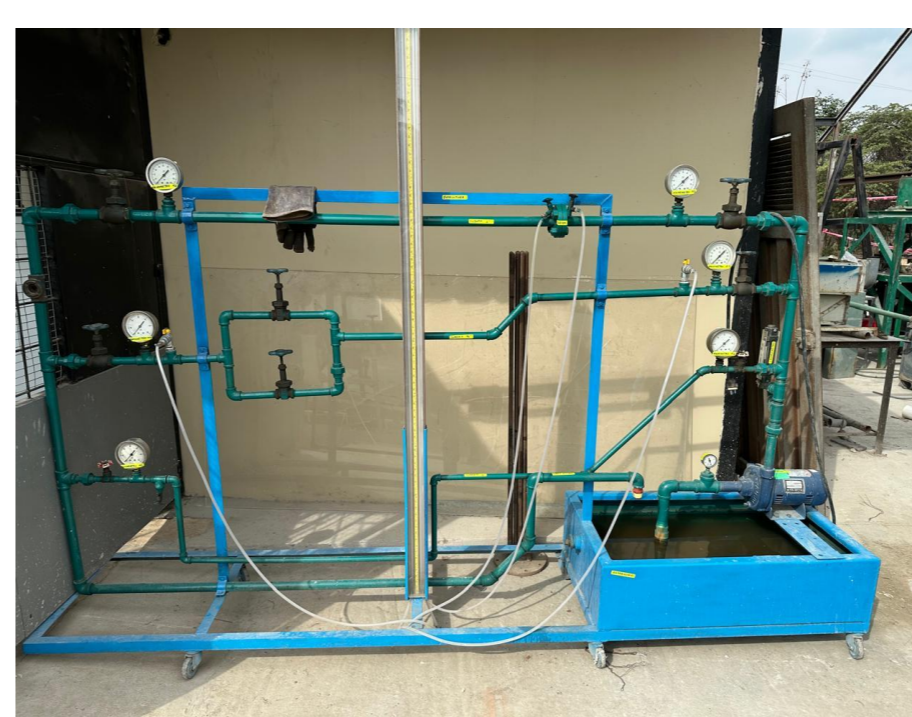
Banco hidráulico readecuado
