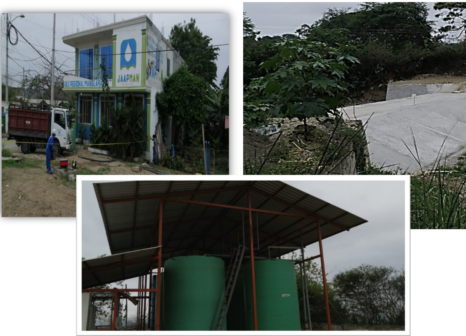
Imágenes de infraestructura de la JAAPMAN
