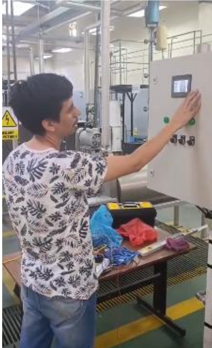
Pruebas realizadas con la bomba de vacío para probar el correcto funcionamiento del controlador
