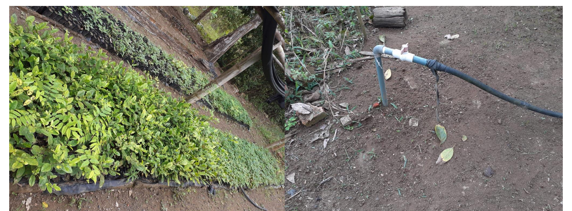
Sistema de riego deficiente dentro del vivero
