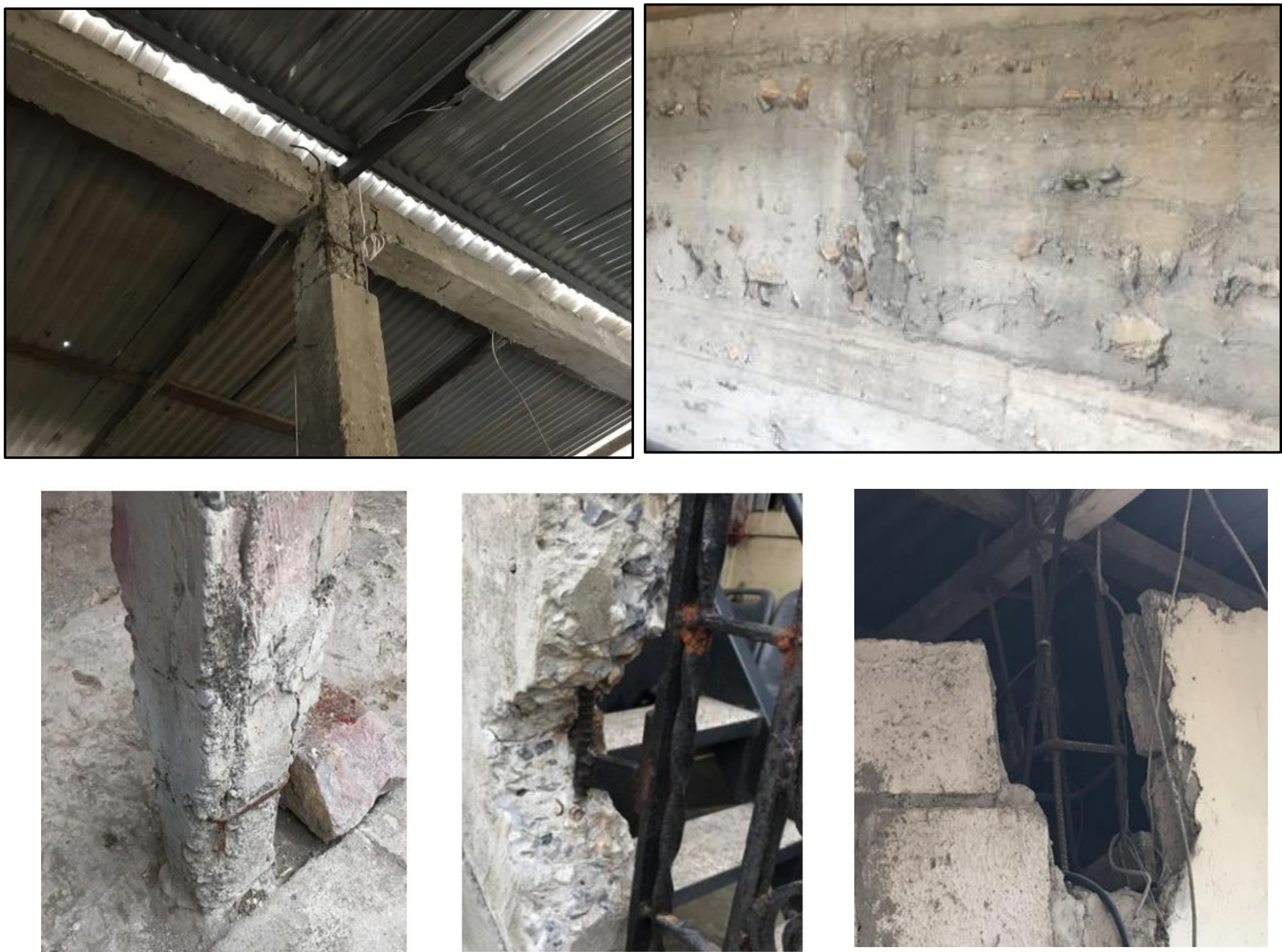
Figura 4. Deficiencias encontradas. Arriba ( Izq-Der : Conexión inadecuada de viga-columna, Cavidades en muros de contención. Abajo ( Izq-Der: Segregación de hormigón en columna, Remoción intencional de concreto, Inadecuada conexión de cubierta con estructura de madera).
