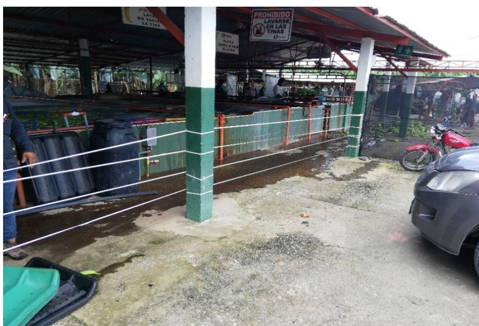
Incorrecta delimitación de zonas
