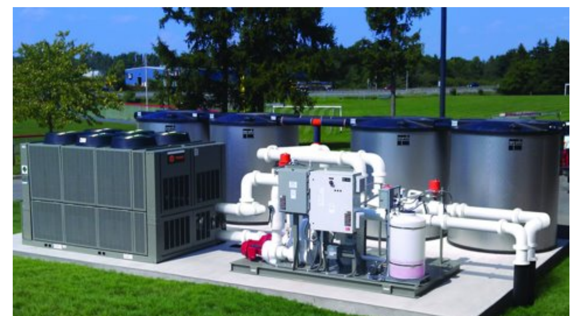
Figura 3. Componentes del sistema de almacenamiento.
